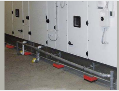
Виброизоляция блочных ТЭЦ с помощью упругих опор
