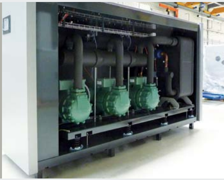
Эффективная установка теплонасосов на упругие опоры
